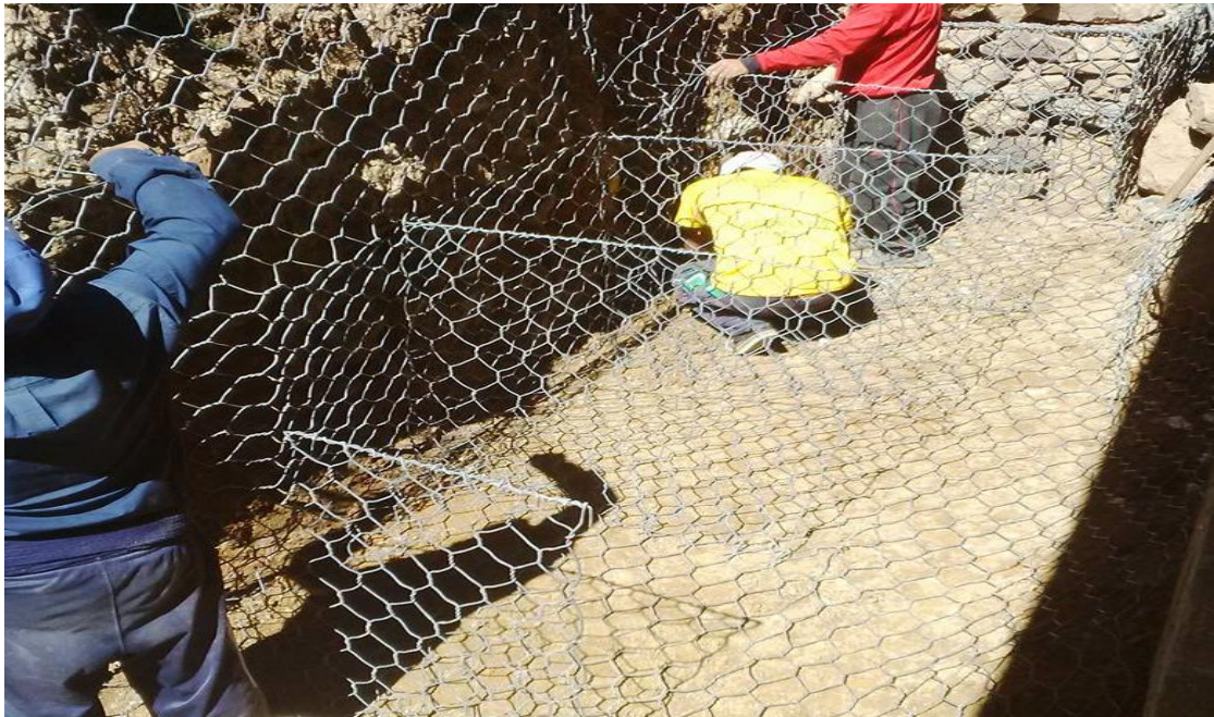
7.- Nivelamos y Procedemos al Llenado de los Cajones con piedra de la cantera
