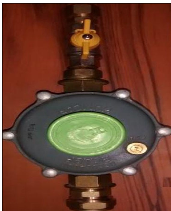
Figura 10. Foto de Regulador de Presión de gas.
