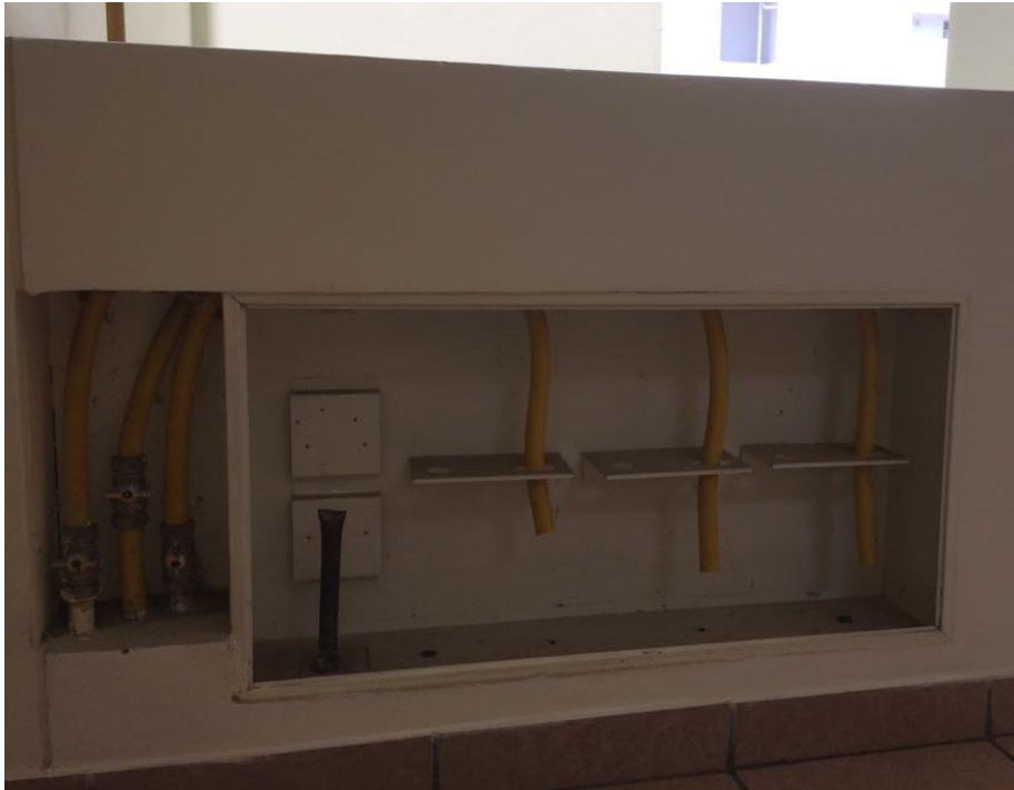
Gabinete triple, cobertura de reguladores y medidores.
