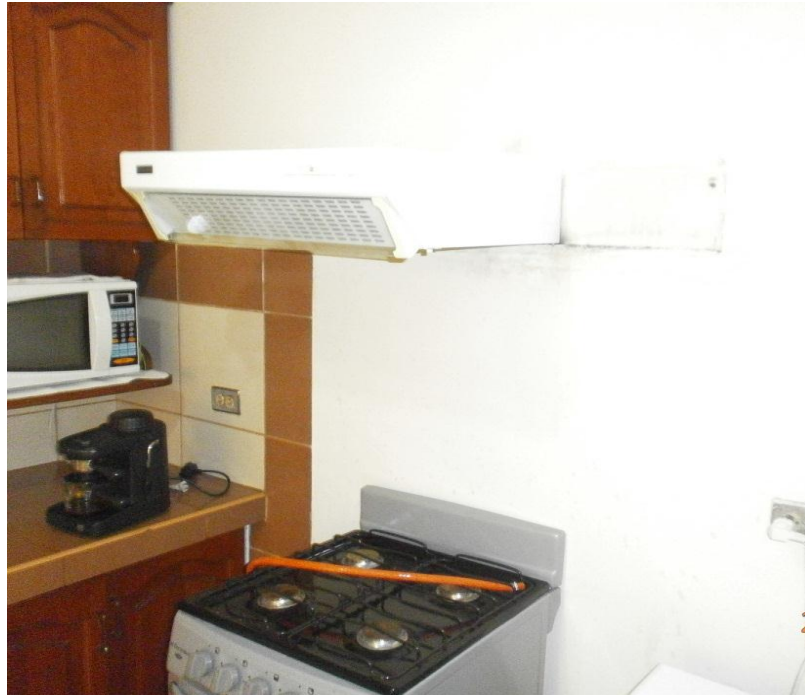
Gasodomicos (cocina) de los departamentos del edificio multifamiliar.
