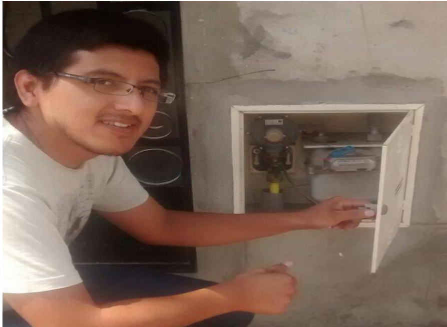
Vista del regulador de primera etapa, en gabinete s22.
