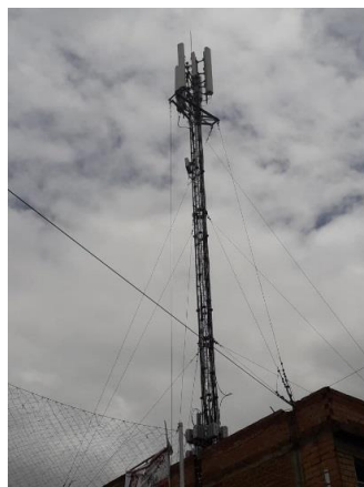
Figura 52: estación repetidora urbanización cruz de motupe Fuente: Elaboración propia de autor
