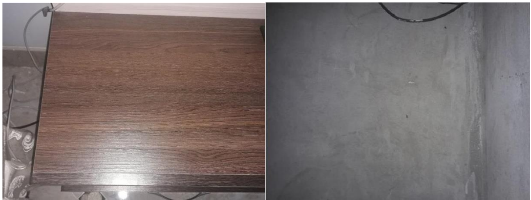
Figura 62: antes de la instalación de router y switch
