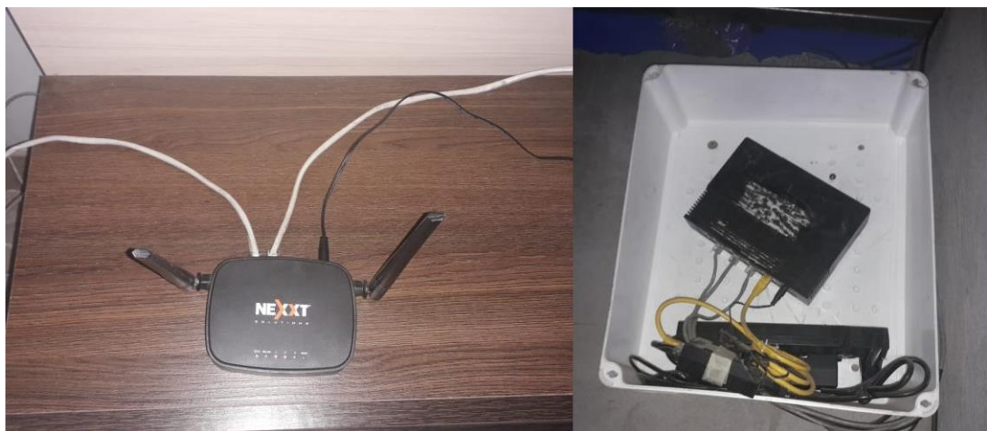
Figura 63: Después de la instalación de router y switch
