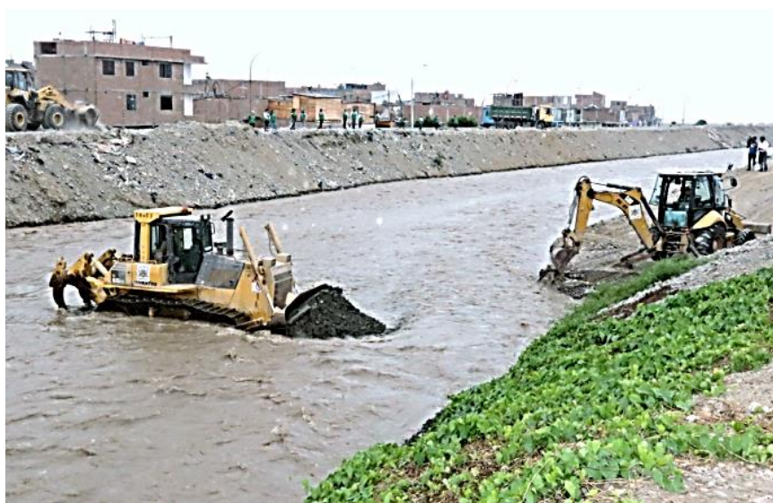
Foto: Vista del primer tramo del río Chillón a la altura de Ila Av. Malecon Chillón en él se observa la profundidad de erosión entre 0.50 a 1.50 m.
