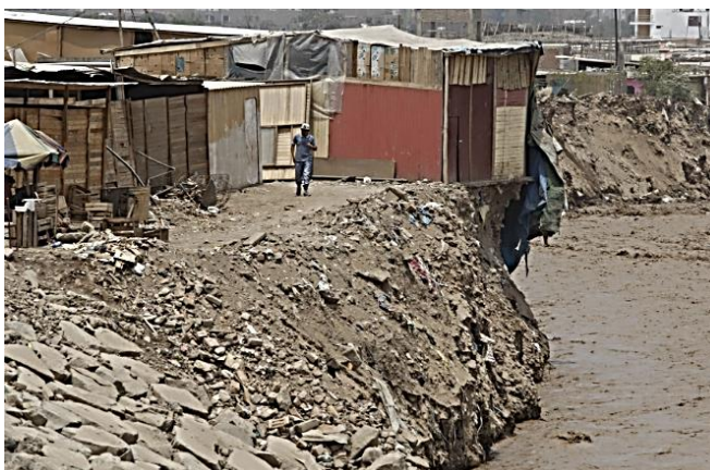
Foto: vista de la erosión de talud en el segundo tramo.
