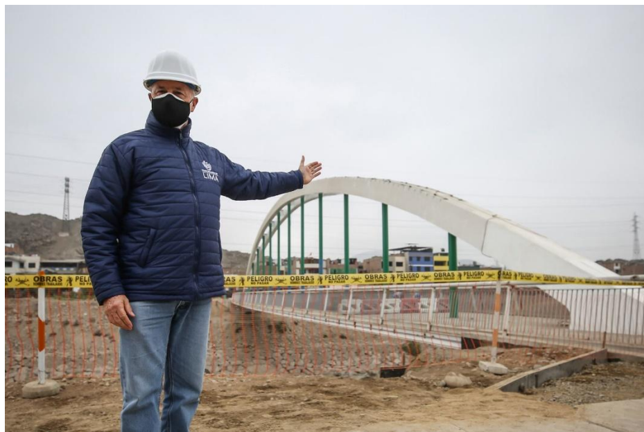
Figura N°1. Reconstrucción del puente malecón checa (estado actual)
