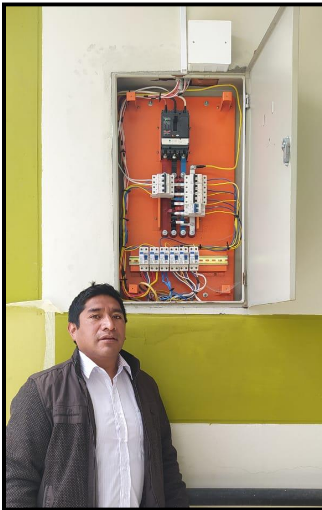
FUENTE: Tablero Eléctrico de la I.E.
