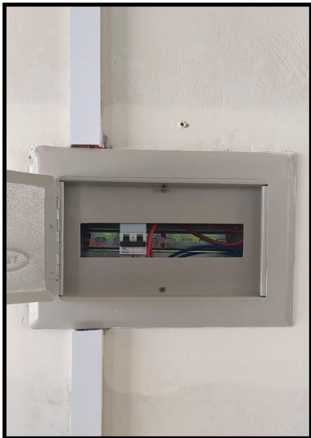
FUENTE: Tablero Eléctrico de la I.E.
