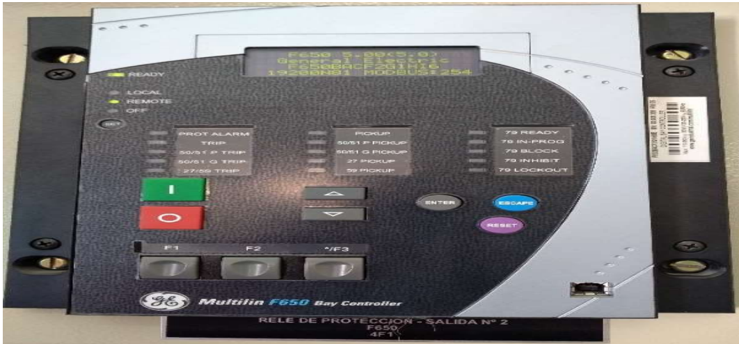
Relé Protección Salidas: 01, 02, 03, 04 y 05 – GE F650 – 3F1.
