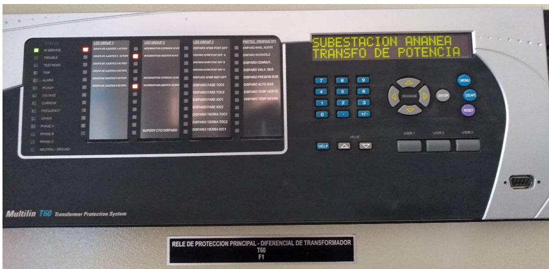
Relé Protección Principal – DIF TRAF0 – GE – T60 F1.
