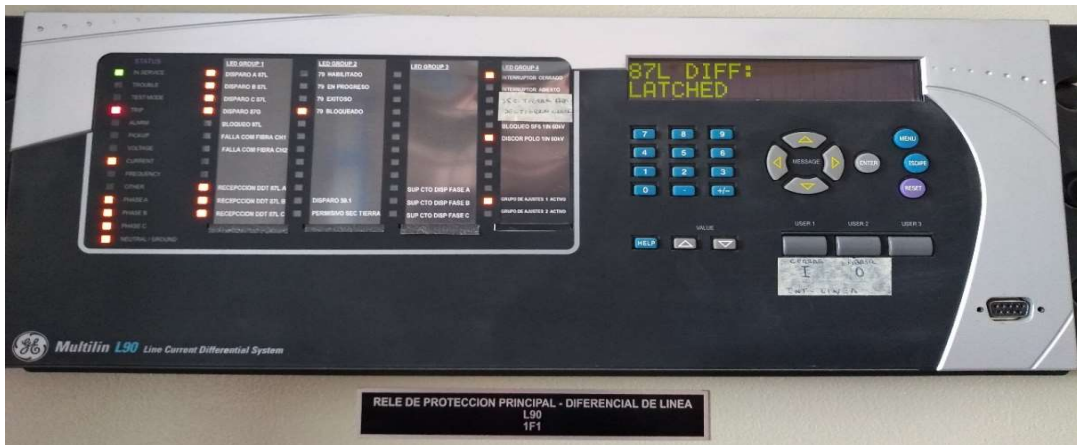
Relé de Protección Principal – Diff. Línea – GE L90 1F1.
