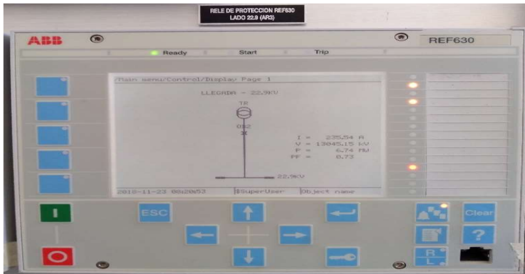
Relé Protección ABB REF630 – AR3 22.9KV.
