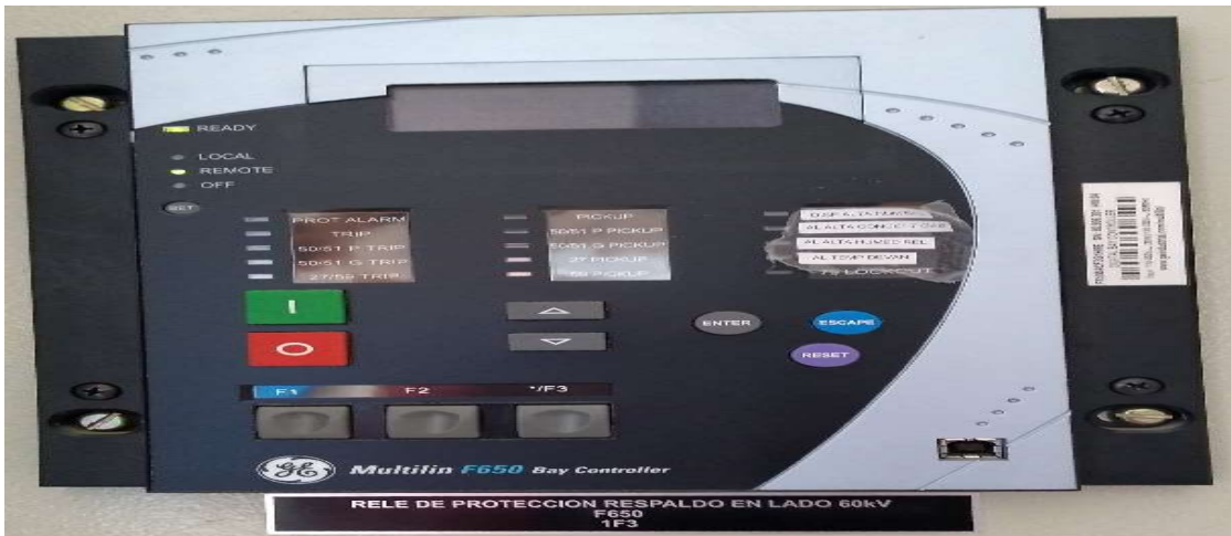
Relé Protección Respaldo 60kv- OC - GE - F650 - 1F3
