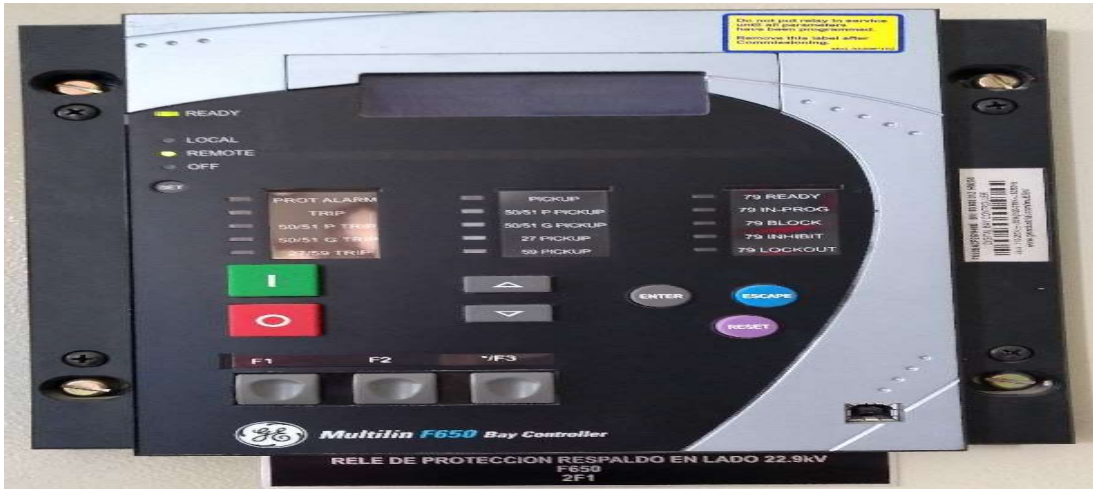
Relé Protección de respaldo 22.9 Kv. General electric F650.
