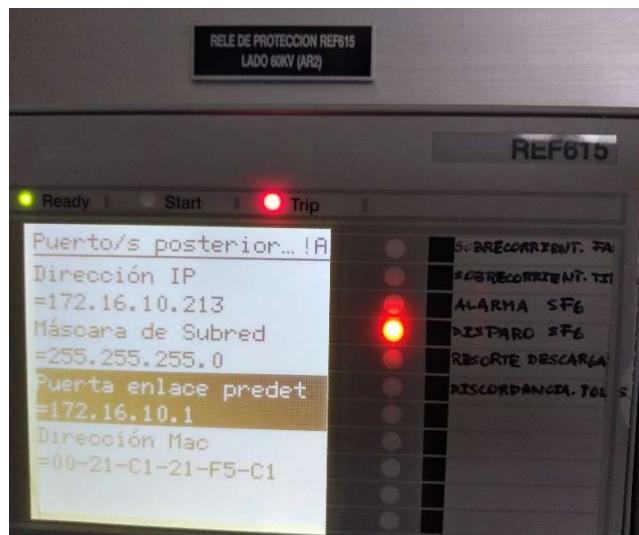
Ip del relé (actual).
