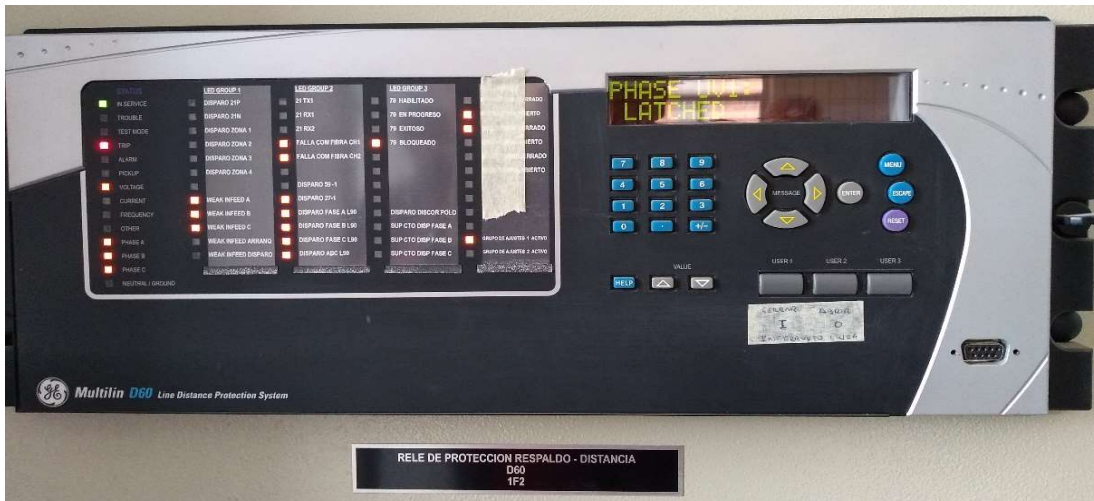
Relé Protección Respaldo – DIS – GE D60 – 1F2.
