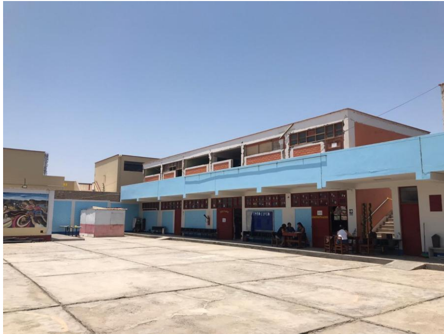
Figura 28: pabellón “A” afectado por causa del terreno del 2007 Fuente: elaboración propia
