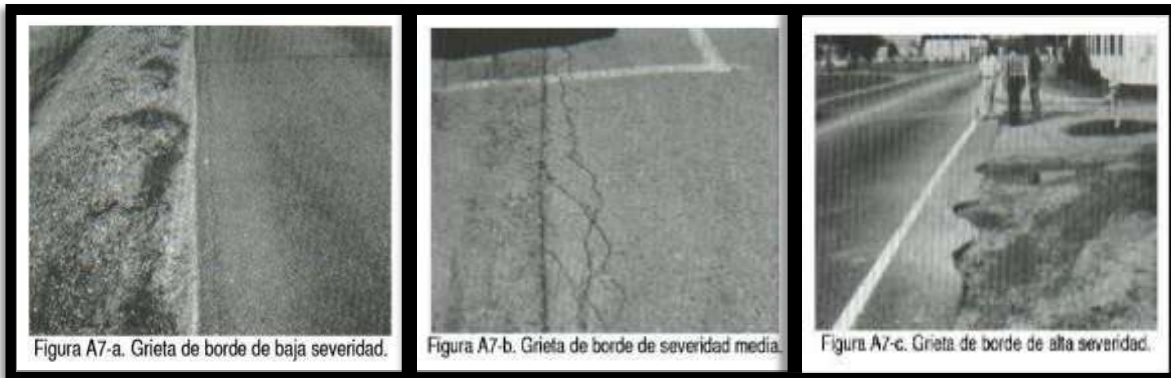
Figura 11. Grieta de Borde Nivel de Severidad (A) Baja, (B) Media, (C) Alta. Fuente: Pavement Condition Index (PCI), (2002).
