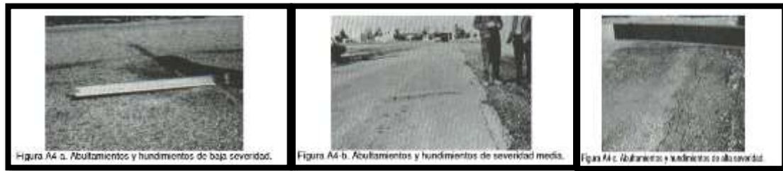
Figura 8. Abultamiento y Hundimiento Nivel Severidad (A) Baja, (B) Media, (C) Alta Fuente: Pavement Condition Index (PCI) , (2002).
