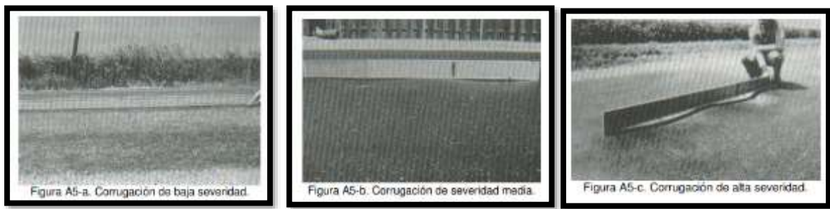
Figura 9. Corrugación Nivel de Severidad (A) Baja, (B) Media, (C) Alta Fuente: Pavement Condition Index (PCI), (2002).
