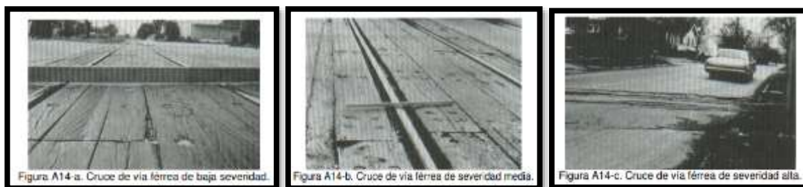
Figura 16. Cruce de Vía Férrea Nivel de Severidad (A) Baja, (B) Media, (C) Alta Fuente: Pavement Condition Index (PCI), (2002).
