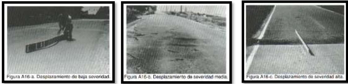
Figura 18. Desplazamientos nivel de severidad (a) baja, (b) media, (c) alta Fuente: Pavement Condition Index (PCI) , (2002).
