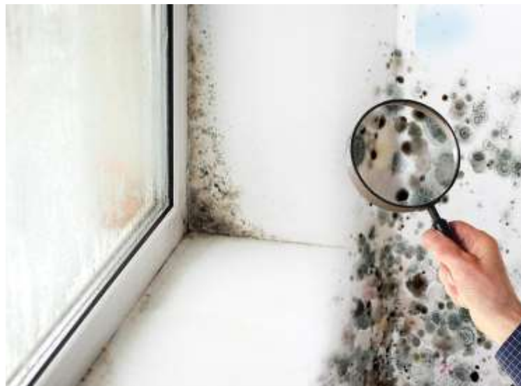
Figura 21. Hongos producidos por la humedad Fuente : ONsalus
