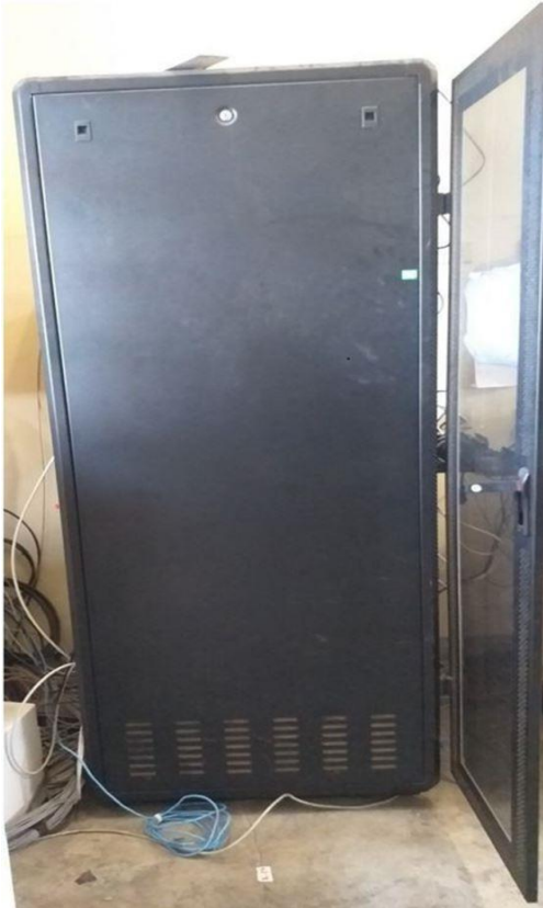
Figura 43 Rack de 42ur.
