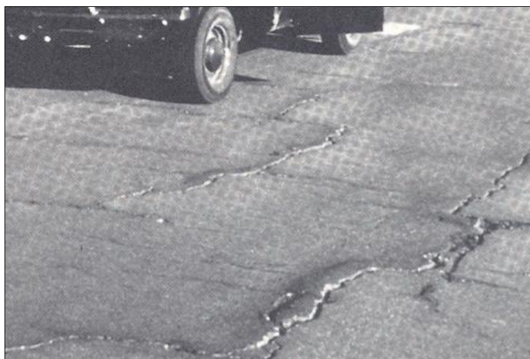
Figura 17. Fisura en bloque nivel de severidad alto.
