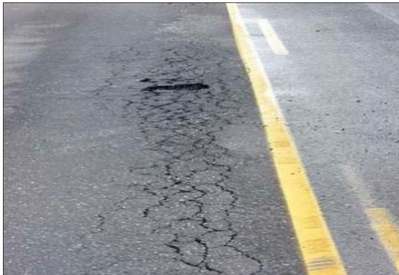
Figura 13. Piel de cocodrilo nivel de severidad medio.
