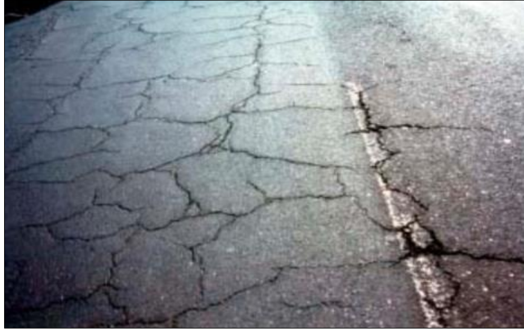
Figura 16. Fisura en bloque nivel de severidad medio.
