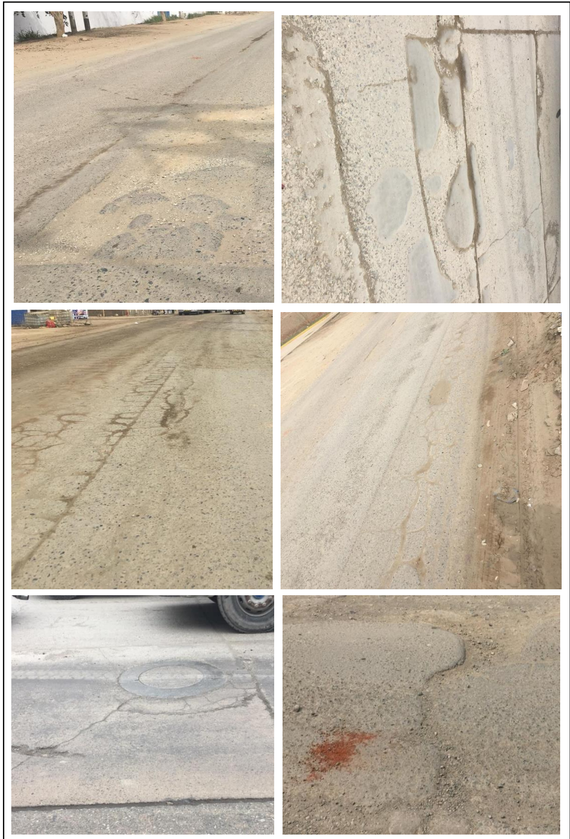
Falla tipo “Grietas transversales y longitudinales” del pavimento estudiado
