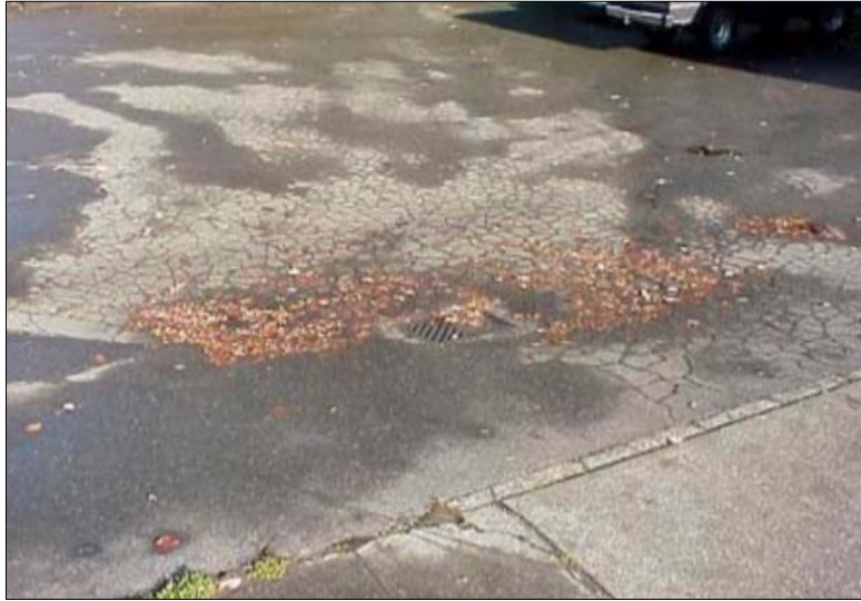
Figura 14. Piel de cocodrilo nivel de severidad alto.
