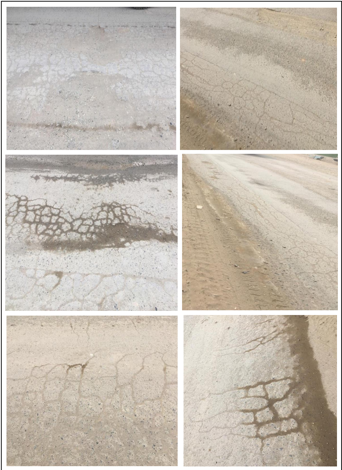
Fallas tipo Piel de cocodrilo en el pavimento flexible estudiado
