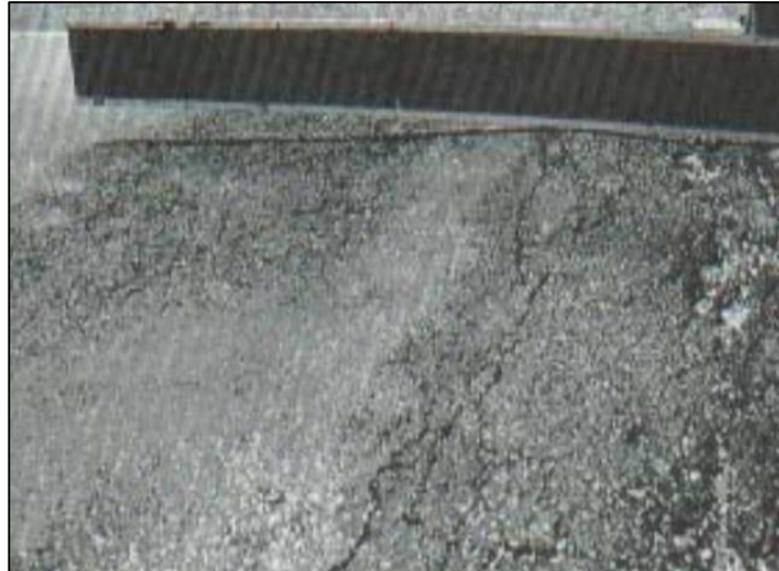
Figura 26. Hundimiento nivel de severidad alto.
