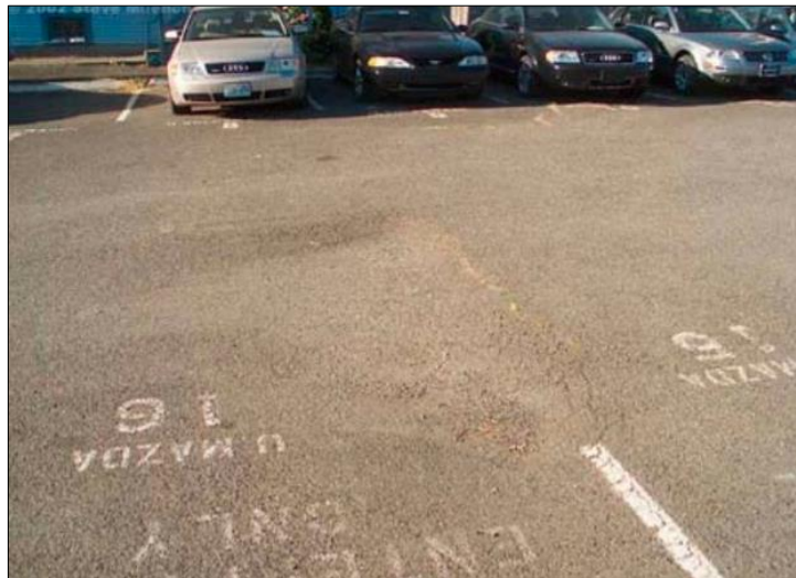
Figura 25. Hundimiento nivel de severidad medio.
