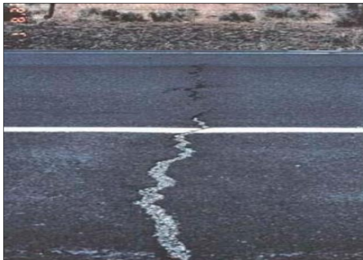
Figura 23. Fisura longitudinal y transversal nivel de severidad alto.
