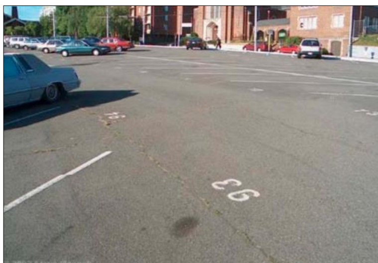
Figura 20. Fisura de reflexión de junta nivel de severidad bajo.
