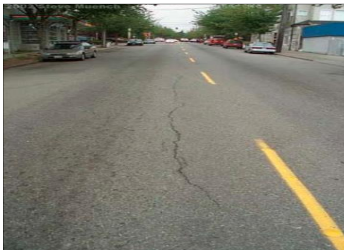
Figura 22. Fisura longitudinal y transversal nivel de severidad bajo.
