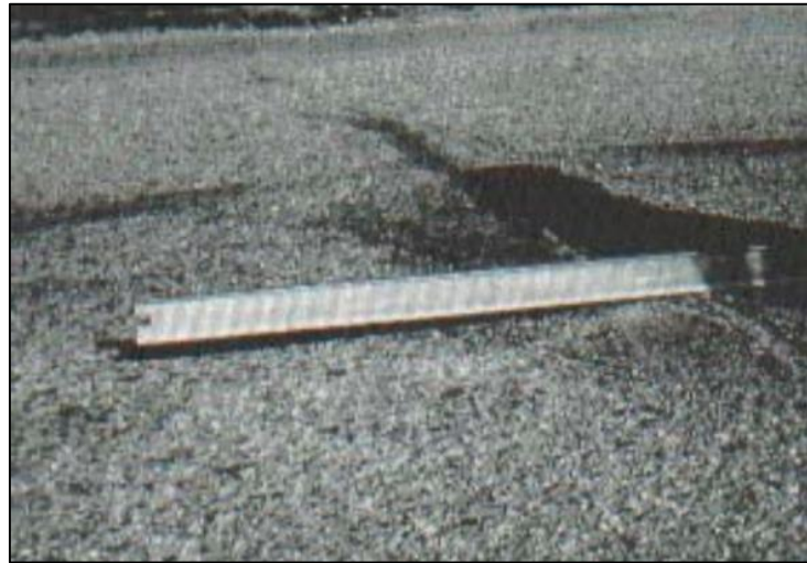
Figura 24. Hundimiento nivel de severidad bajo.
