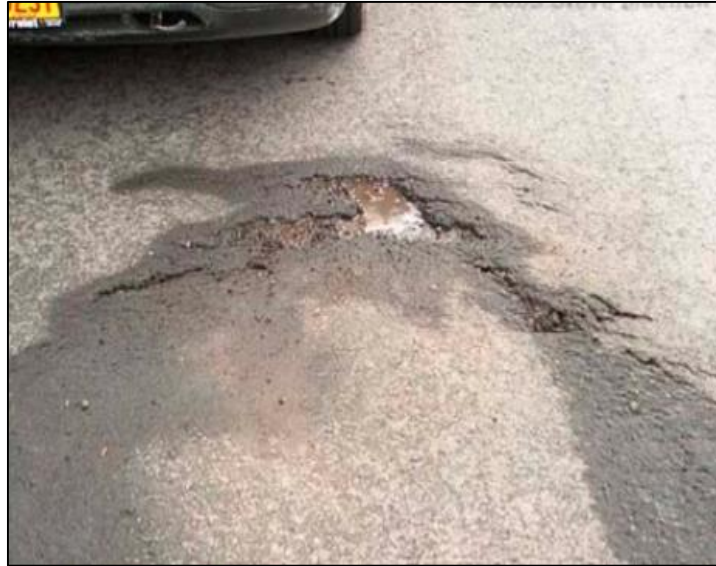
Figura 30. Grietas de desplazamiento nivel de severidad alto.
