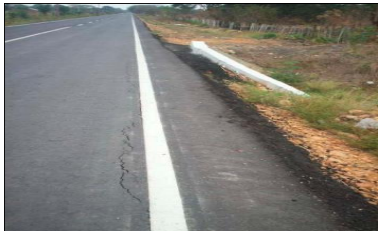
Figura 18. Fisura de borde nivel de severidad bajo. Fuente: Corredor y Corros (2019)
