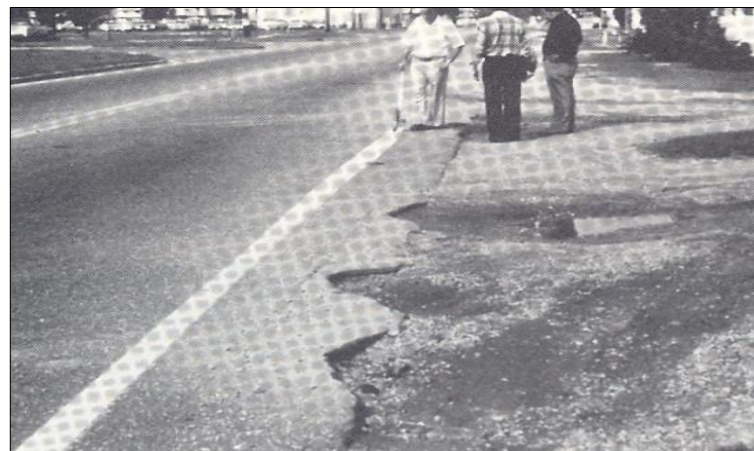
Figura 19. Fisura de borde nivel de severidad alto. Fuente: Corredor y Corros (2019).
