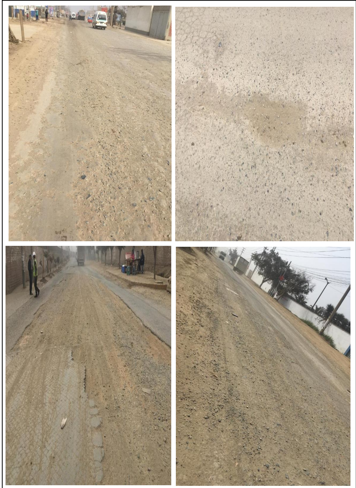
Falla tipo “desprendimiento de agregados” del pavimento estudiado
