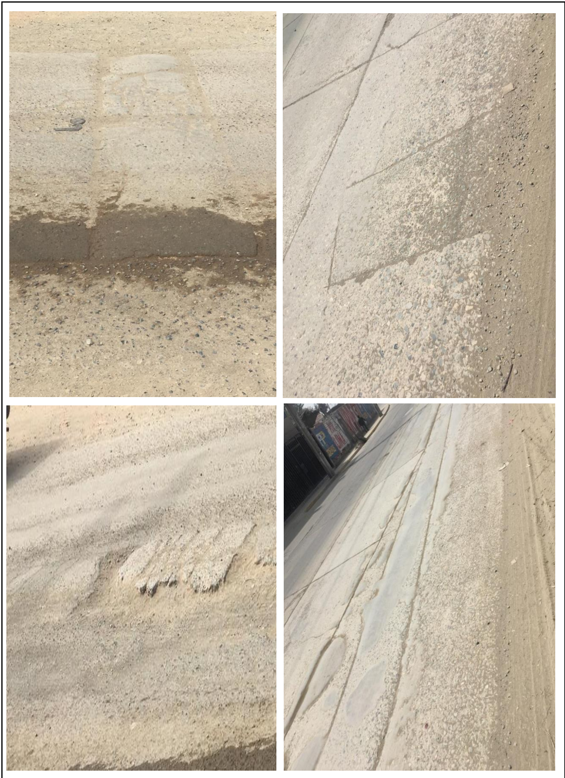
Fallas Grietas en bloque, longitudinales y hueco
