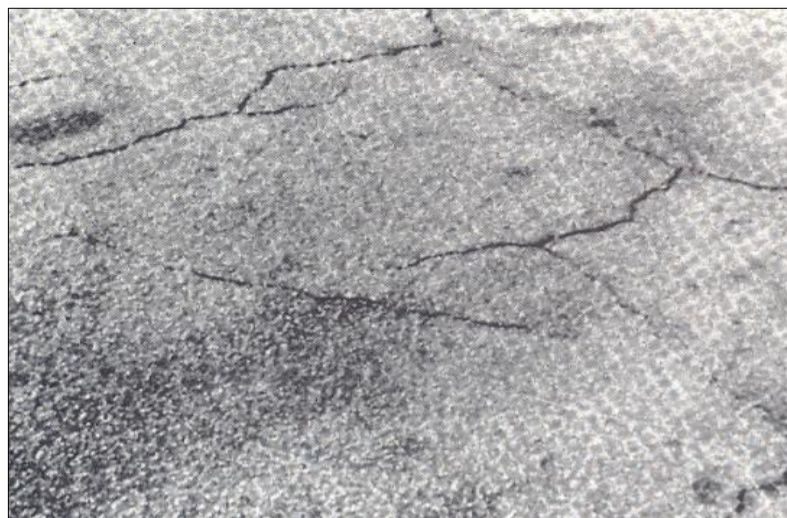
Figura 15. Fisura en bloque nivel de severidad bajo.
