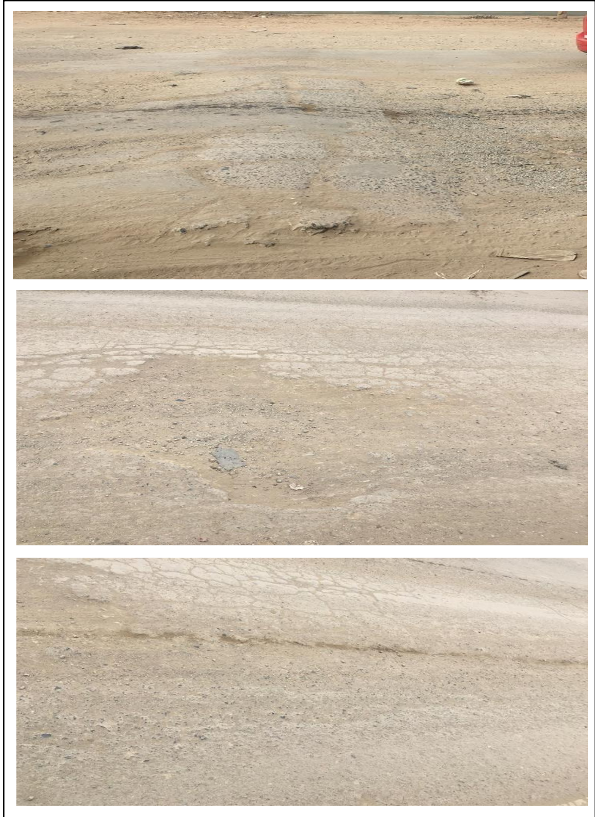
Falla tipo “Abultamiento y hundimiento” del pavimento estudiado
