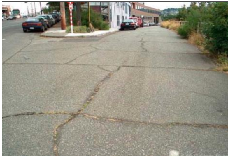
Figura 21. Fisura de reflexión de junta nivel de severidad alto.
