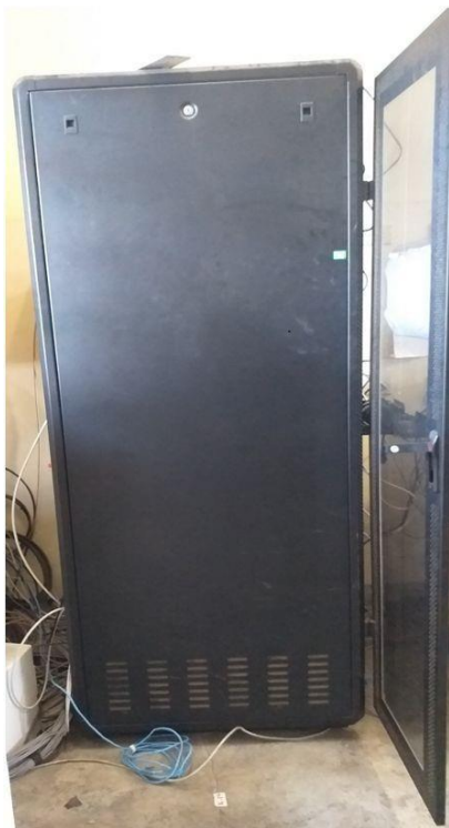
Figura 4.5. Rack de 42ur.
