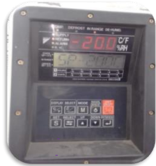
VERIFICACIÓN DE TEMPERATURA -18 ° C - 20° C
