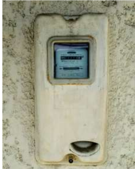
Figura 2. Medidor eléctrico Fuentes: Elaboración propia de autor
